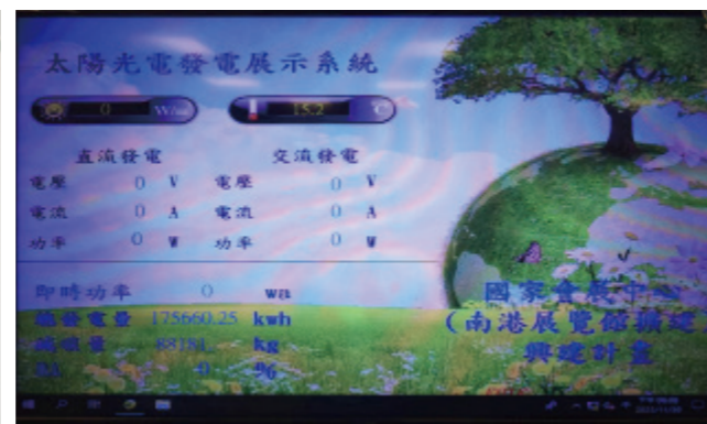
中控室 太陽能發電系統監視畫面
