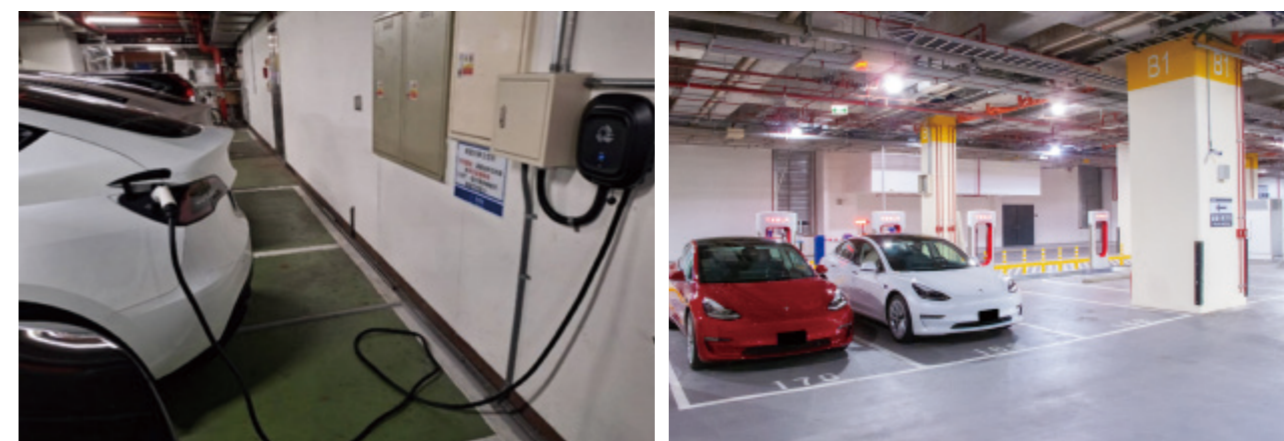
南港 1 館電動車充電樁
