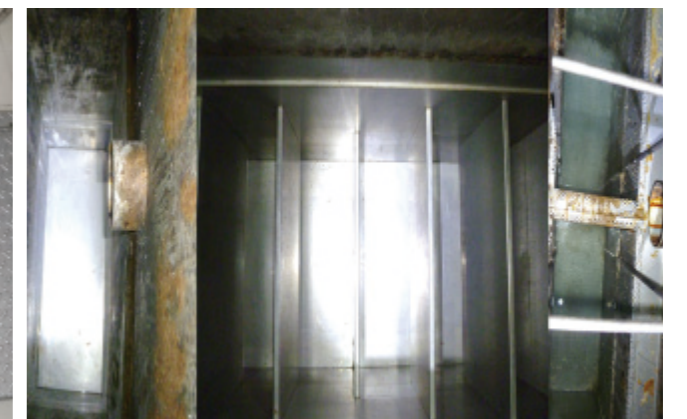
大型油脂截留槽
