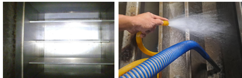
排油煙靜電機清洗及設備維護
