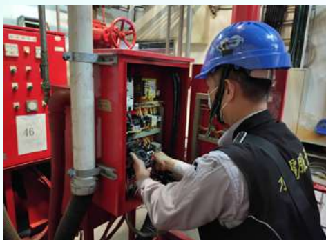
消防設備定期保養
