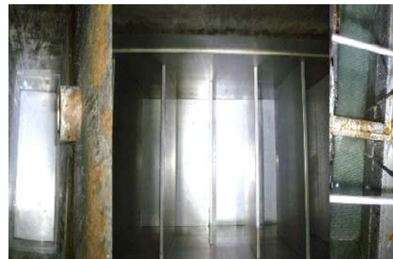
大型油脂截留槽
