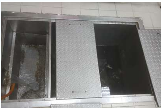
簡易油脂截留槽
