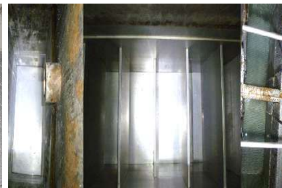
大型油脂截留槽
